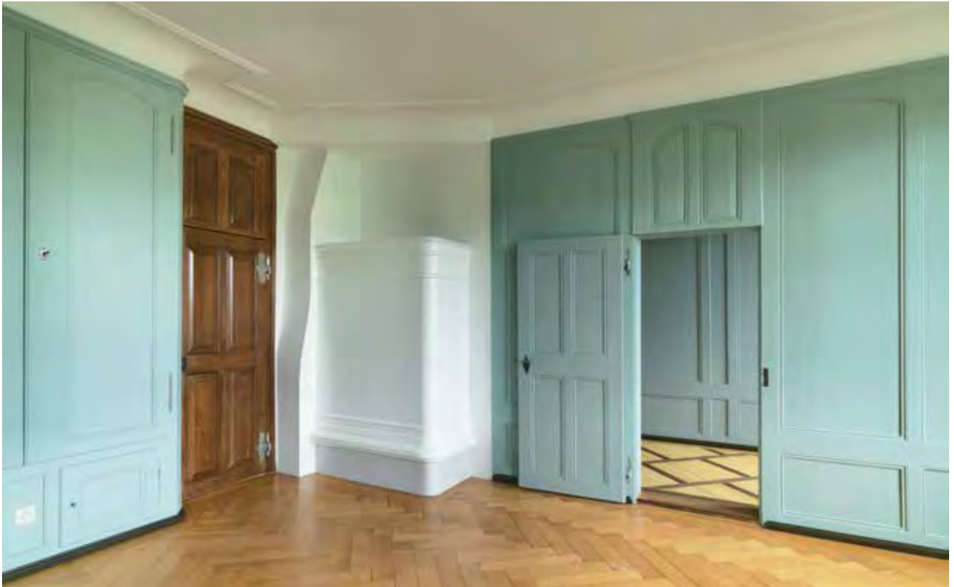
Zimmer 23, Erdgeschoss (Aufnahme 2012): Instandgestellte Wandvertäfelungen mit Neufassung des ersten Anstriches. Abgelaugte Eichentüre mit freigelegten Originalbeschlägen. Gipsatrappe eines Ofens aus der Bauzeit als Verkleidung eines Ofens um 1940.
