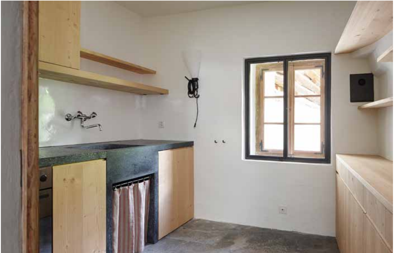
1. Obergeschoss: Neue Küche mit Abdeckung und Becken aus pietra ollare. Aufnahme nach der Renovation.
