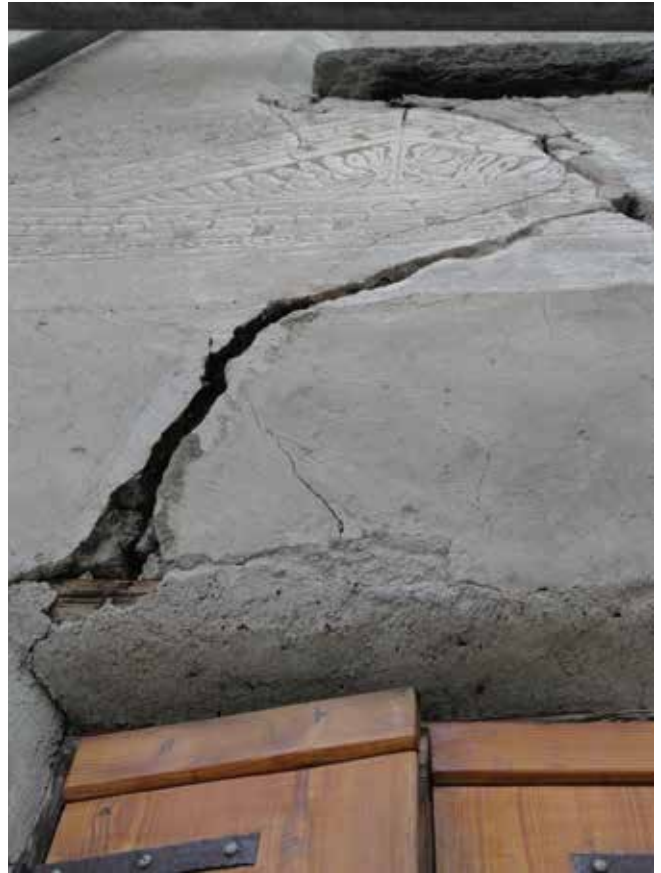
Freigelegte Risse. Aufnahme während der Restauration.
