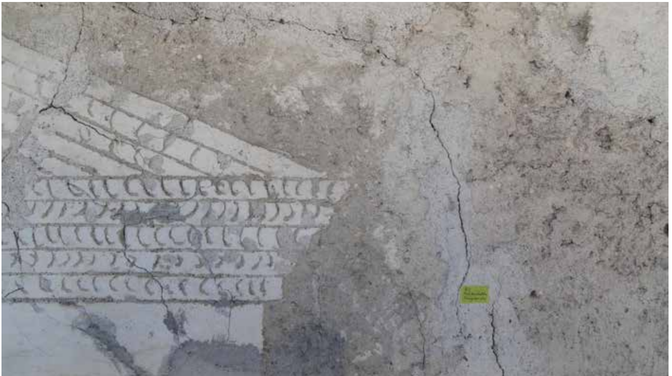
Schadenaufnahmen. Aufnahme während der Restauration.
