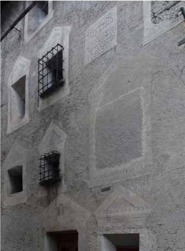
Cäsa Cortini: Aufnahme vor der Restaurierung mit zugemauertem Fenster.
