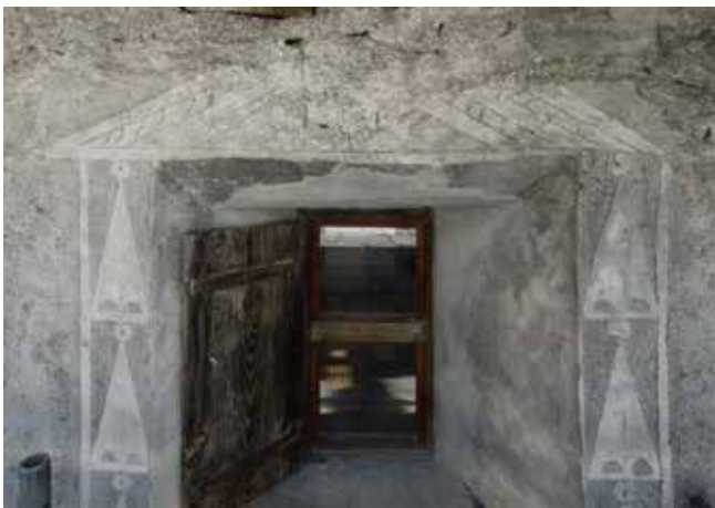
Cäsa Cortini: Detail Fensterumrandung 3. Stock. Zustand vor Sanierung.
