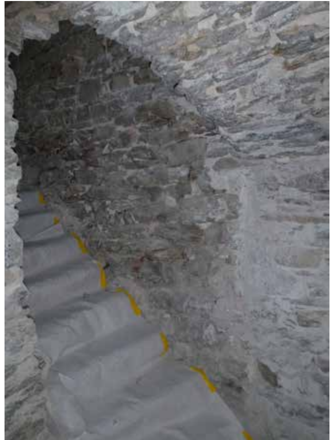
Cäsa Cortini: Zustand nach der Entfernung des Zementputzes von 1972. Mauerwerk von 1616. Aufnahme 2014.
